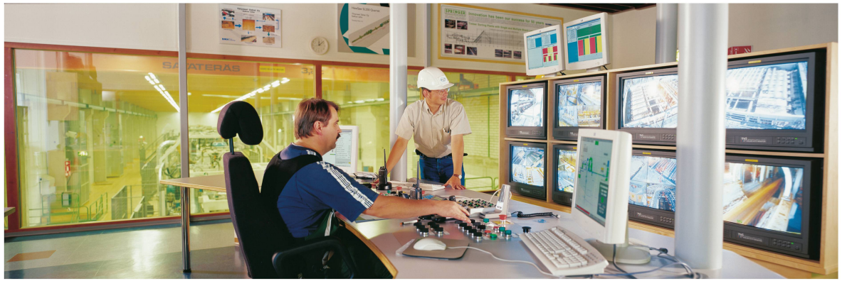
Abb 3 Zentrales Steuerpult in einem GSW. Foto: UPM Kymmene
