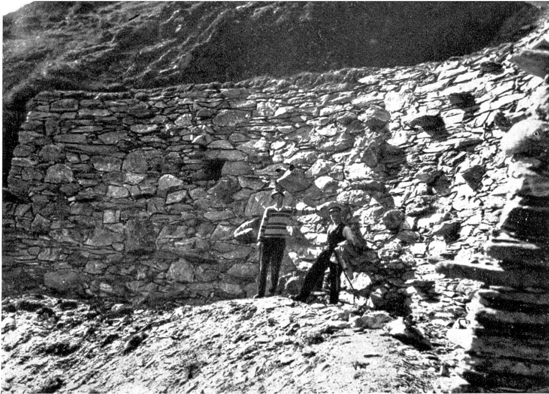
Gekrümmte Mauer in einem Graben des Schönbühls, Lawinenverbauung Faldum Schlechtes Beispiel
