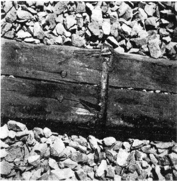
Marque des roues sur une traverse de bois en bon état.
