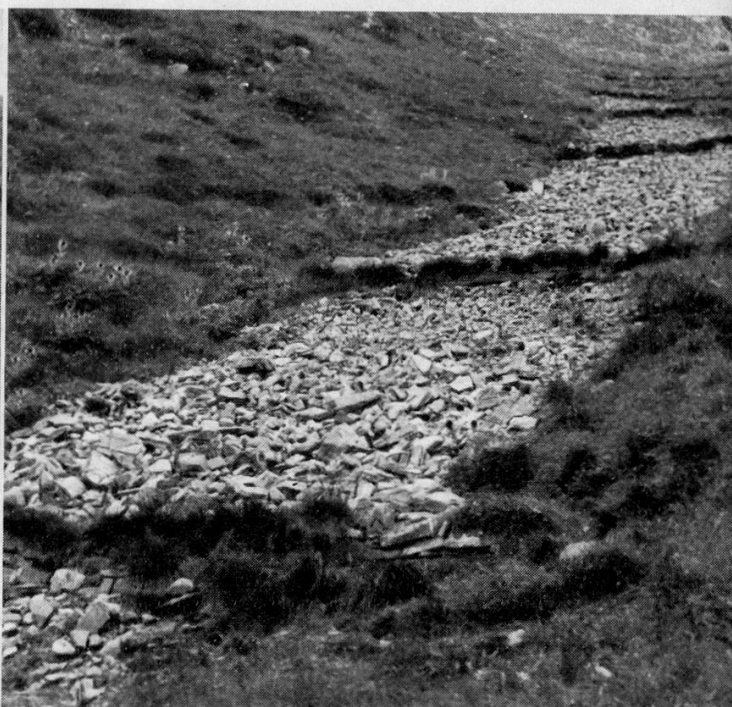
Fig. 4. Enherbement de pentes d'éboulis, après la construction de petits ouvrages transversaux et mise en réserve du territoire en cause.
