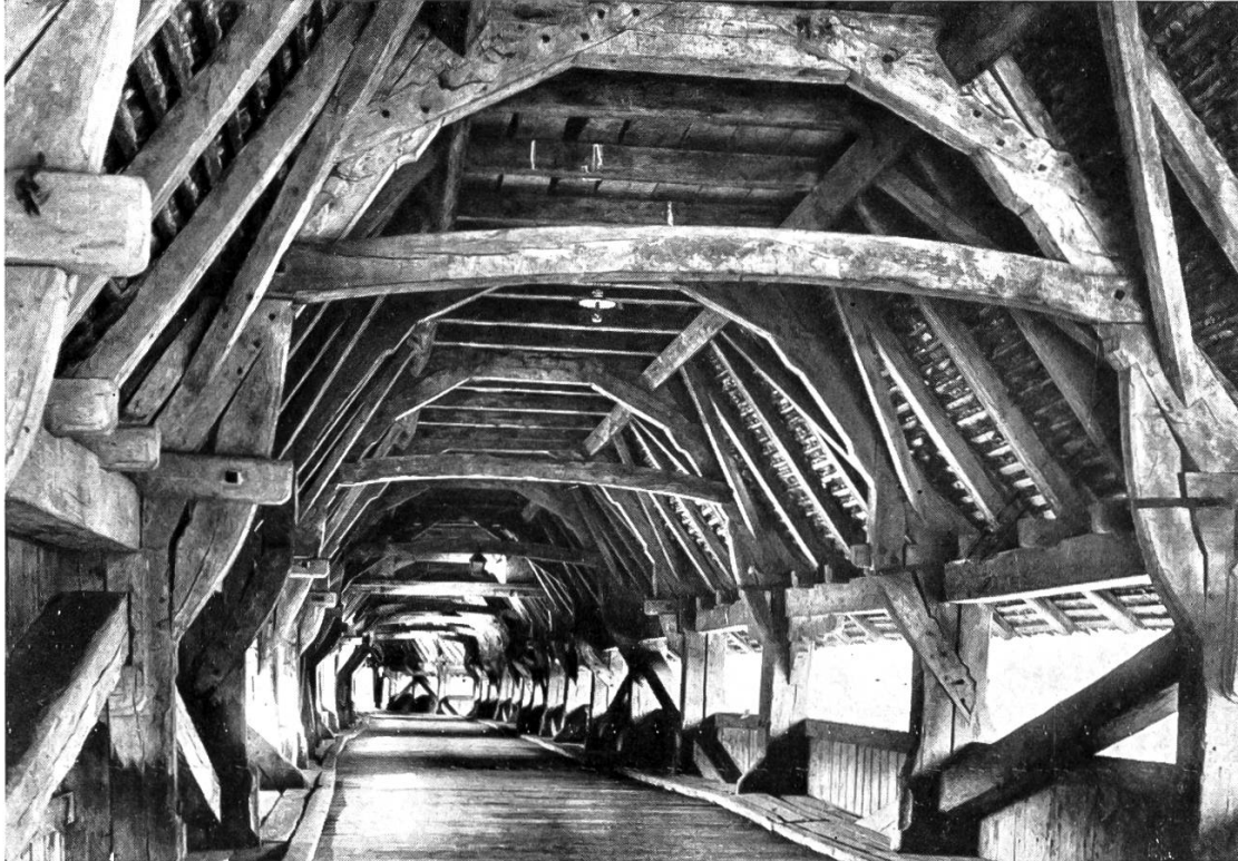
PONT EN BOIS SUR L'AAR, PRÈS DE BERNE, CONSTRUIT EN 1535 Vue de l'intérieur
