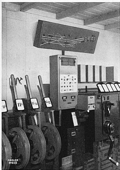
Stationsausrüstung für einen automatischen Block mit fernbedienter Blockstelle, angebaut an ein mechanisches Stellwerk. Rechts die Hebelsperren und in der Mitte der Bedienungsapparat.
