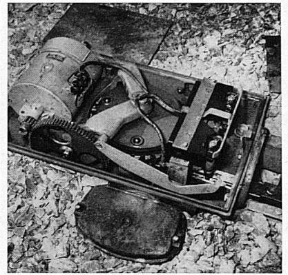
Chaque aiguille est actionnée par un moteur électrique commandé à distance. Jede Weiche wird durch einen elektrischen, ferngesteuerten Motor geschaltet. Photo Presse-Diffusion, Lausanne
