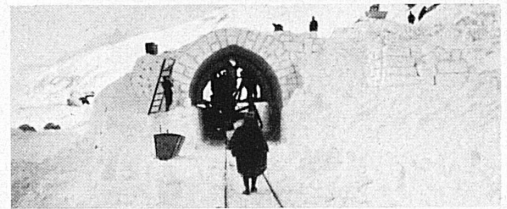
Oben: Provisorische Erstellung einer Schutzgalerie an der Oberalp. – Ci-dessus: Erection provisoire d'une galerie de protection sur la ligne de l'Oberalp. Photo: Bucher
