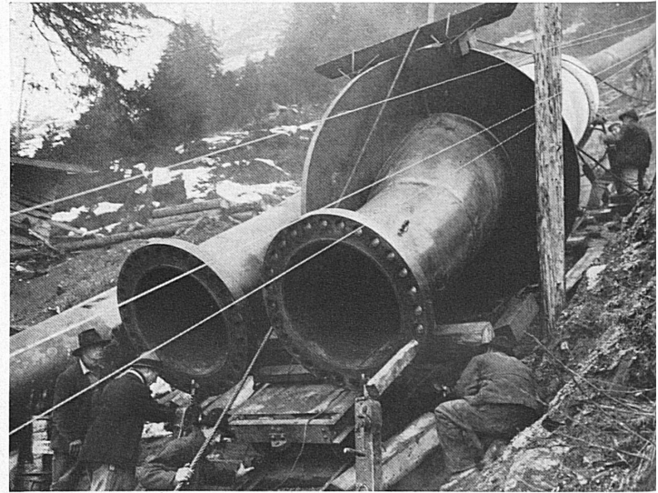
Ein interessantes Teilstück der Druckleitung: Das wichtige Hosenrohr für die Verzweigung des Druckschachtes in zwei freiliegende Rohrstränge. — Partie intéressante de la conduite forcée.
