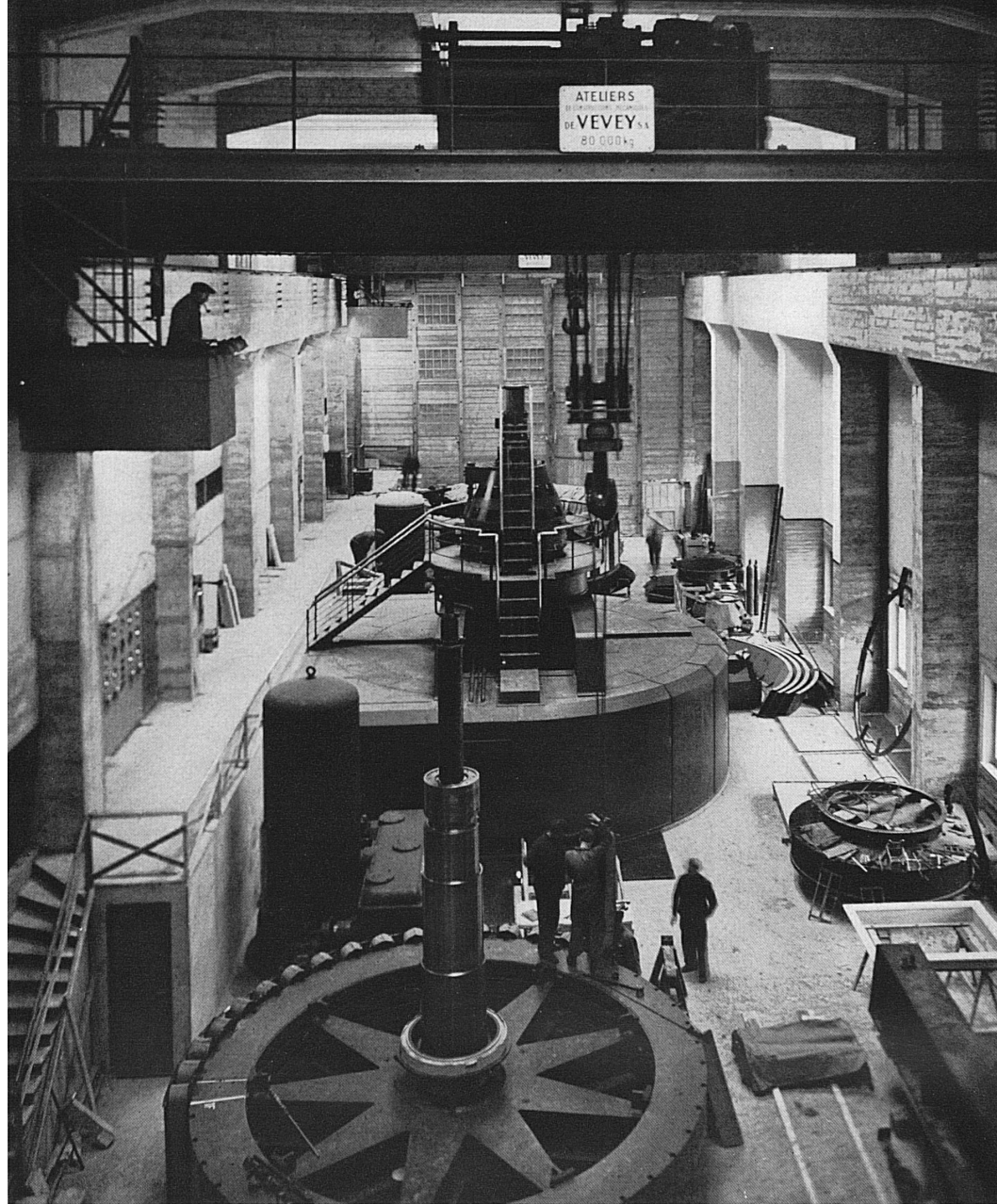
L'usine du Verbois, une partie de la salle des machines avec le premier groupe générateur (31500 CV). Teil der Maschinenhalle in Verbois mit der ersten Generatorgruppe zu 31500 Pferdestärken.
