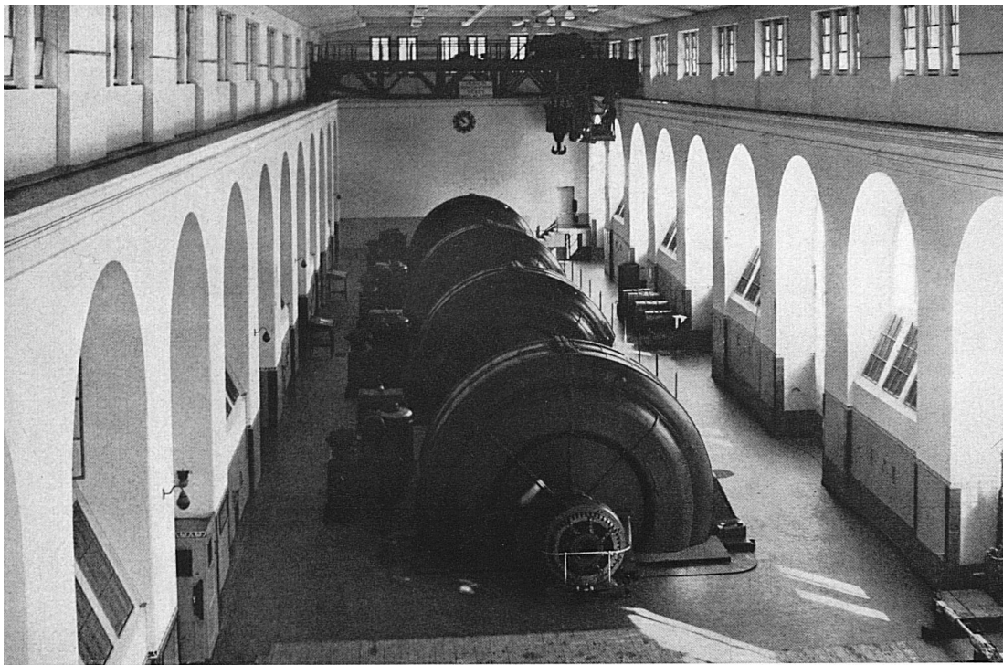
Maschinsaal des Barberine-Kraftwerkes. Mitte: Unterwerk Muttenz. Salle des machines de l'usine électrique de Barberine. Au centre: La sous-station de Muttenz.
