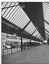
Hall principal de la gare Genève-Cornavin peint avec «Ferrosite» Stella brun cuivre.
