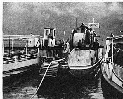
Verlegung eines Telephonkabels im Luganersee zwischen Morcote und Brusino für die Post- und Telegraphenverwaltung. November 1934
