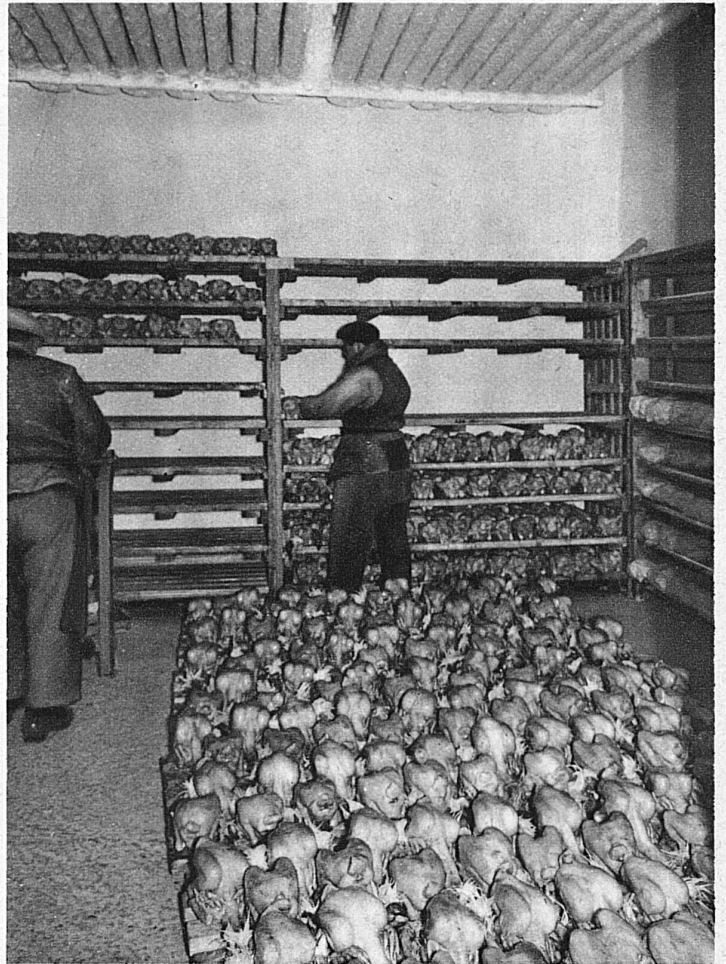
Blick in einen Geflügelraum des Bahnhof-Kühlhauses Genf
