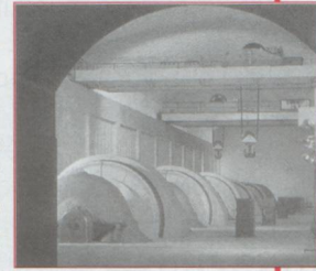
Vue de la centrale souterraine de Fionnay
