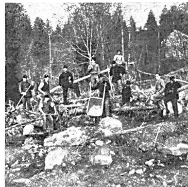
Beginn der Räumung (Unwetterschäden) am Aegerisee
