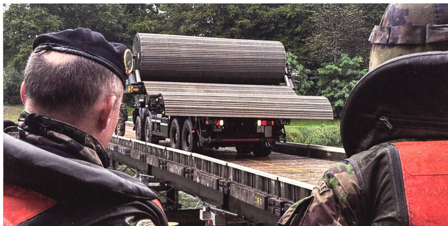
Die erstellte Stahlträgerbrücke wurde vom Logistikbataillon 101 zur Übersetzung von Fahrzeugen bis zur Grösse von Lastwagen genutzt.
