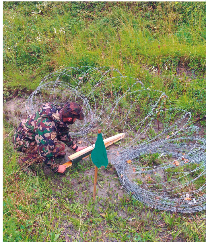
Eine gestreckte Ladung wird während des formellen Sprengens zur Wirkungsdemonstration unter einer Stacheldrahtrolle installiert.
