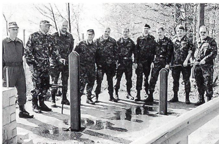
Die Mitglieder des UOV Baselland beim Einbau eines Panzerhindernisses unter Anleitung eines Festungswächters.
