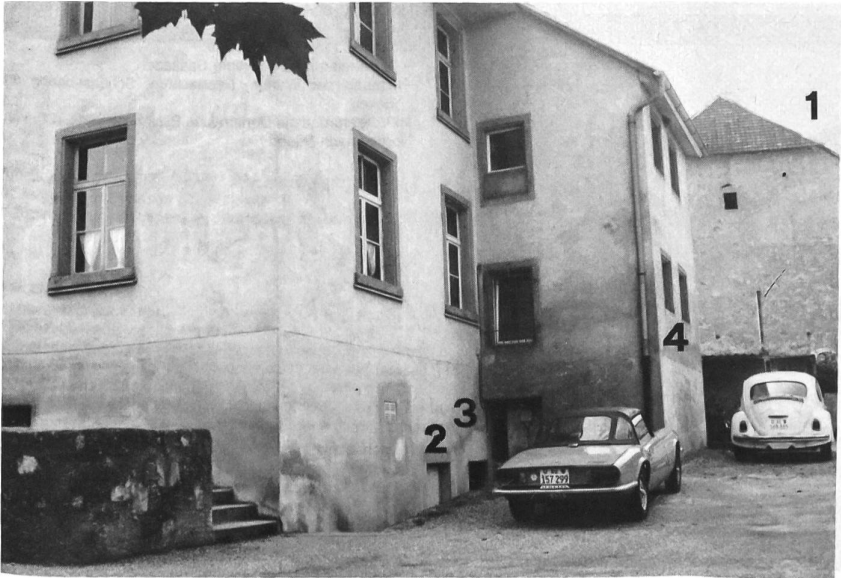
Das «Alte Schulhaus», Südostecke, dahinter die Südfassade des Baugeschäfts (1) - Säubern eines Kellers (2) - Einsatz der Galgenladung (3), (4)
