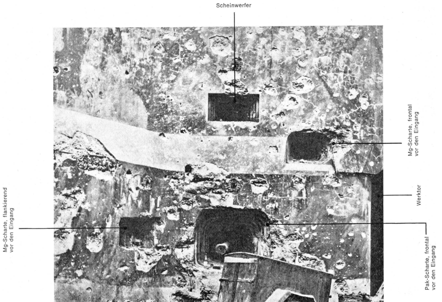
Haupteingang zum Artilleriewerk Eben Emael. Nahaufnahme von Objekt 14, «Scharten der Eingangsverteidigung». Die Beschädigungen an der Betonwand rühren her:
