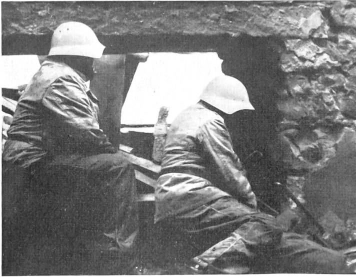
Nach den brennenden Trümmern stellen sich die ersten Hindernisse in den Weg, wie grosse Balken und Bretter, Stahlträger und Mauerwerk, welche die Durchgänge versperrern und weggeräumt werden müssen.
