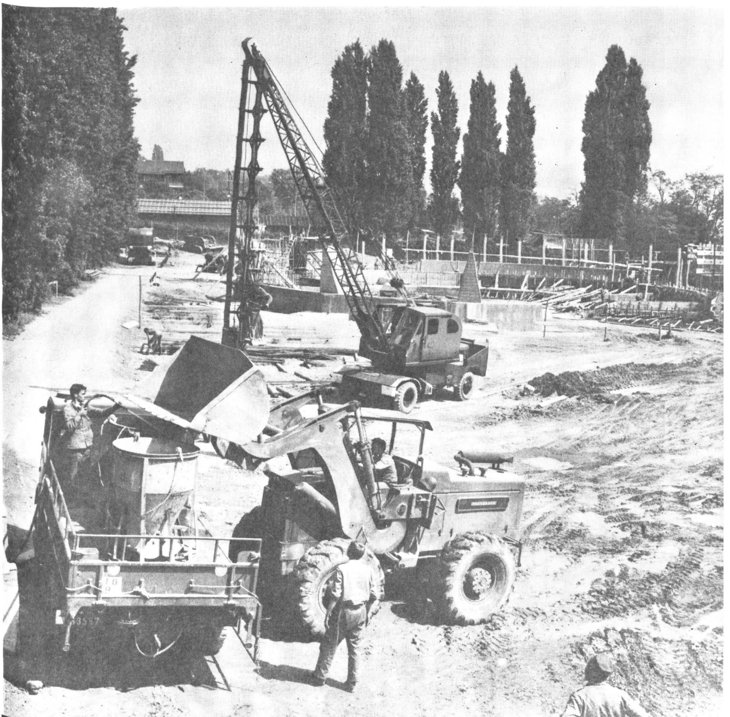
Bild 3 Bauplatz «Wehrhafte Schweiz». Im Vordergrund Pneu- ladeschaufel bei Verladearbeiten. Kranwagen bei Pfählungsar- beiten. Im Hintergrund die Fundamente des «Ige's».
