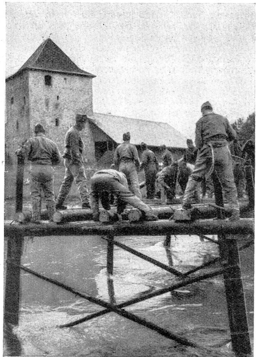
Beim Einsetzen des Tragbalkens Le placement des poutres Phot. K. Egli, Zürich
