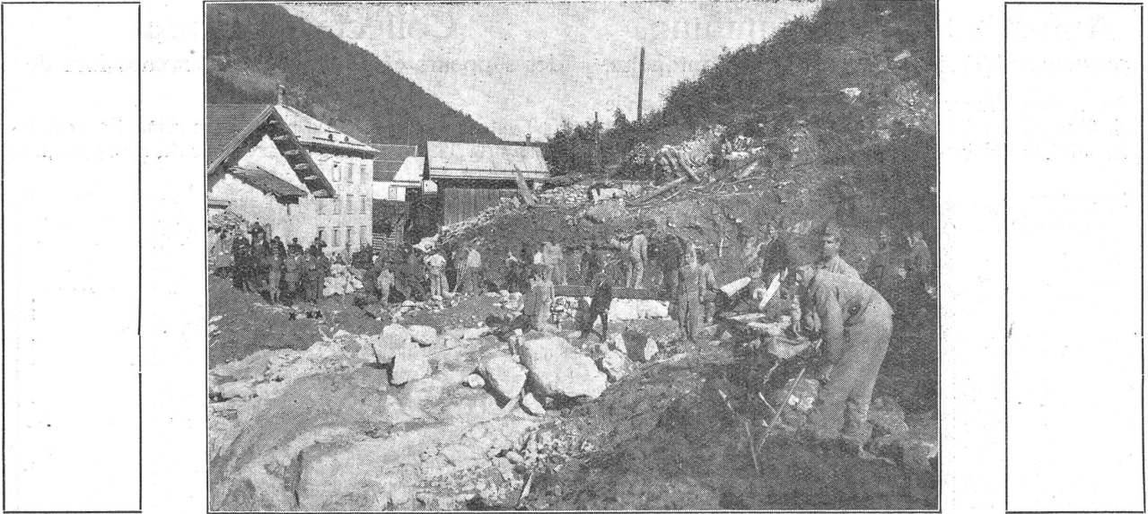
Sappeure des Sapp.-Bat. 6 bei den Räumungsarbeiten in Tavanasa, Sappeurs du bat. 6 des sapeurs aux travaux de déblaiement à Tavanasa (Grisons).
