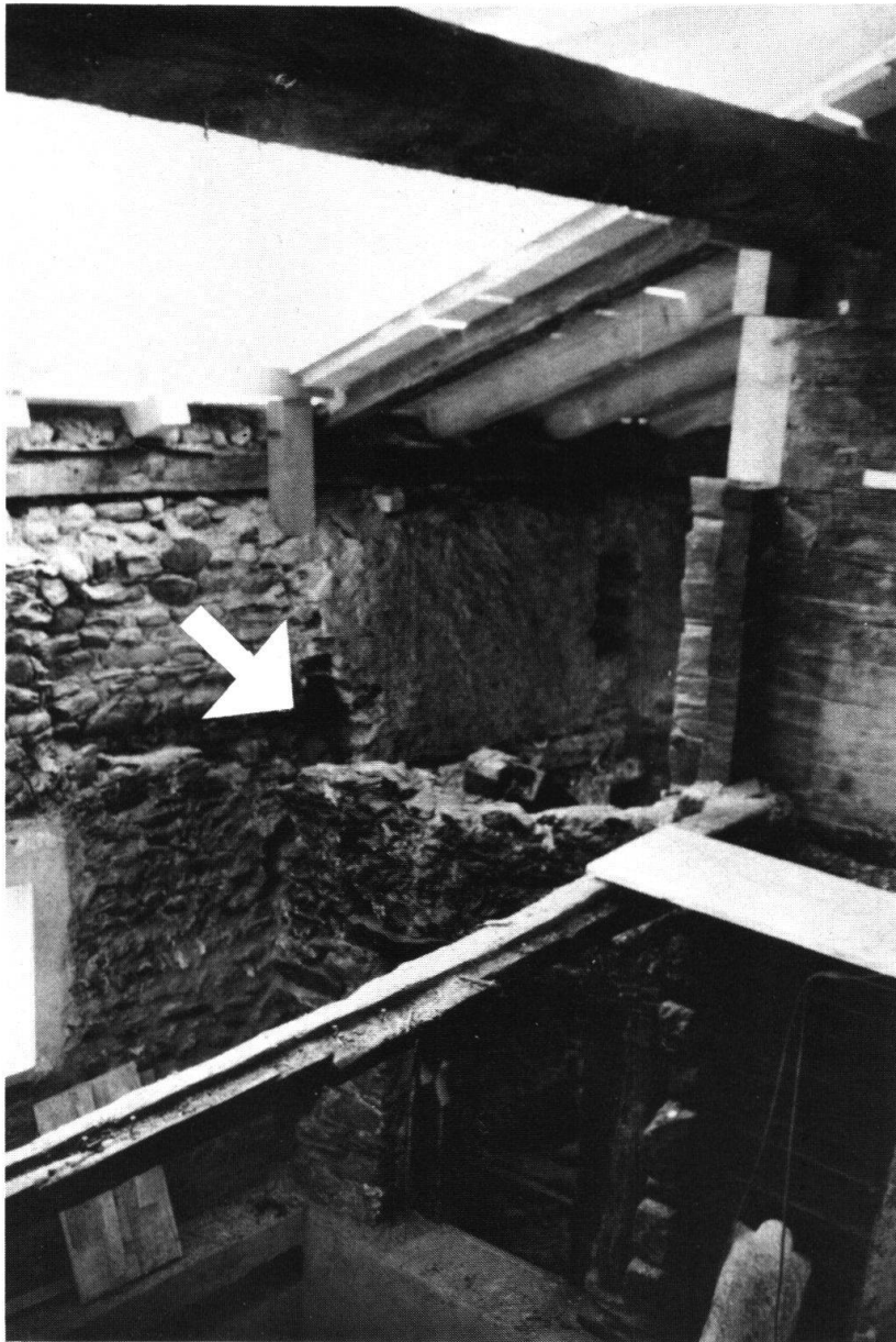
Abb. 3 Fundstelle in der südwestlichen Hauswand.
