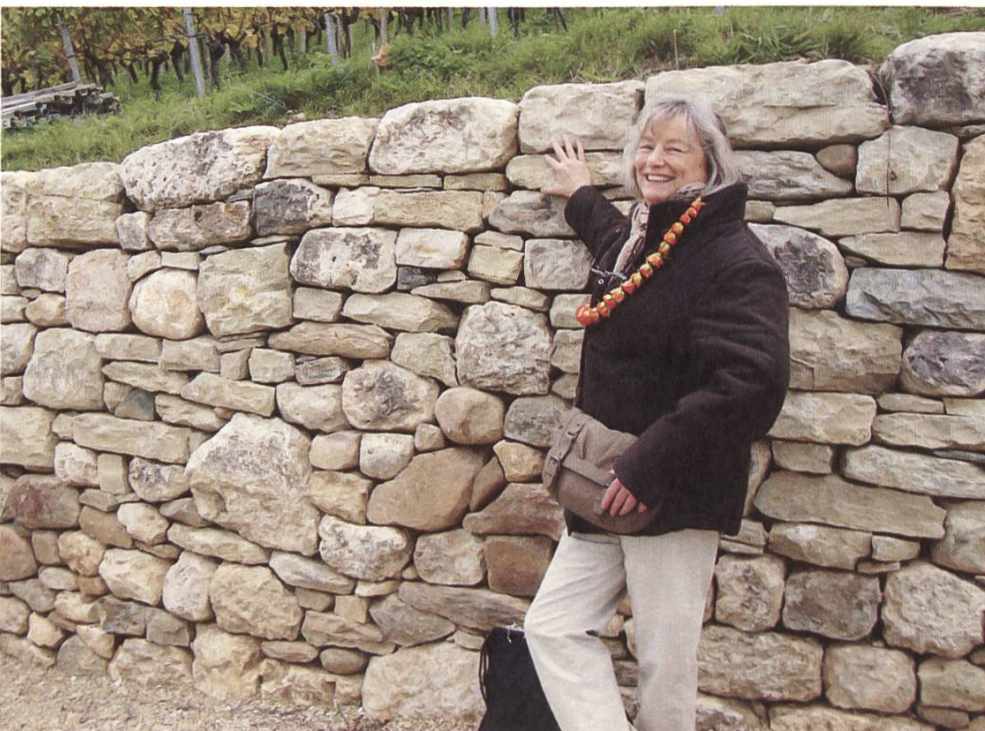
Diese Mauer hält sicher auch 40 Jahre!
