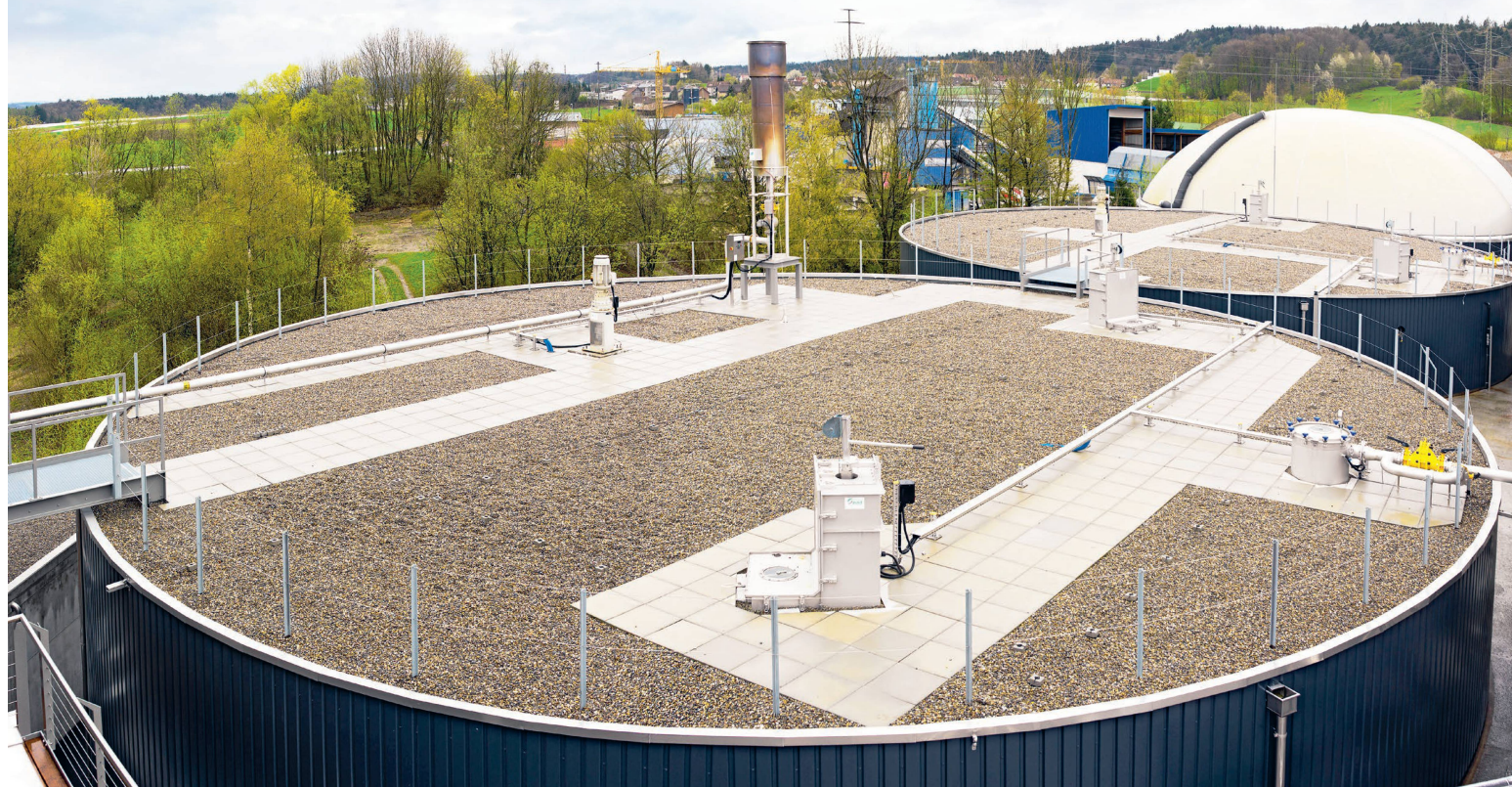
In Nesselbach AG steht die grösste industrielle Biogasanlage der Schweiz. Im Jahr 2021 produzierte sie aus Speiseresten jeweils 18 Mio. kWh Strom und Wärme. Darüber hinaus wurden 30 Mio. kWh Biogas ins Erdgasnetz eingespeist. Bild: Recycling Energie AG
