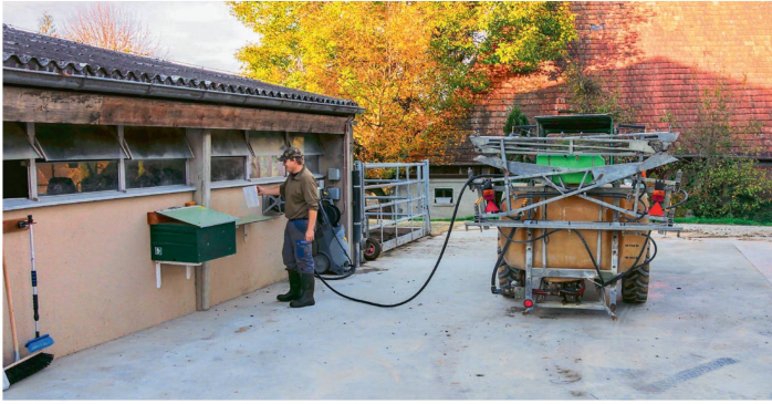
Beispiel mit Güllegrube: Renovation des Belages (aufgrund von Rissen) und Erstellen von besserer Wasserzufuhr für schnelles Befüllen der Feldspritze.
