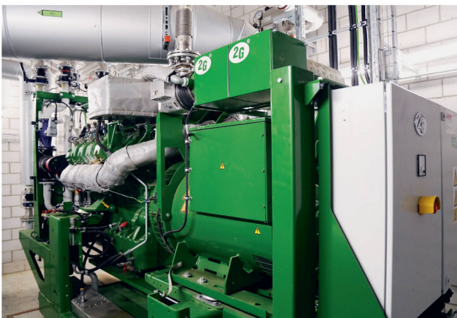
Der mit Holzgas betriebene Motor mit 240 Kilowatt Leistung. Im ersten Monat wurde damit gleich viel Strom hergestellt, wie etwa dreissig Haushalte während eines ganzen Jahres verbrauchen.
