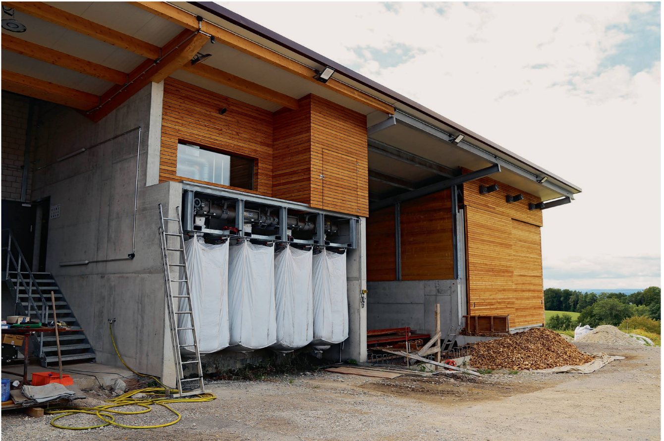
Holzvergasungsanlage in Desibach ZH. Nach dem Produktionsprozess rieselt die Pflanzkohle in die Big Bags. Bilder: Christoph Rutschmann
