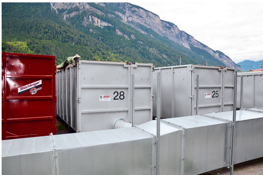
Bei der Container-Trocknung wird das Trocknungsgut von unten mit heisser Luft durchströmt. Bild: R. Hunger
