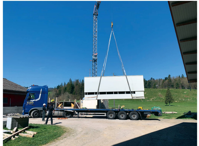
Hier wird von der Firma Jenni ein biologischer Luftwäscher im vorgefertigten Container an seinen definitiven Standort manövriert.
