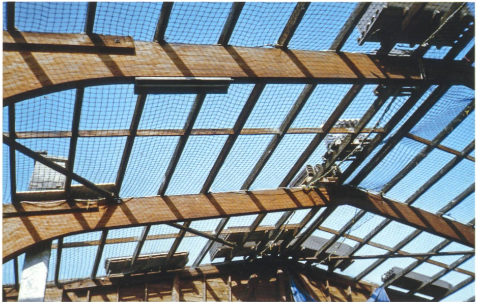
Damit keine Personen durch die Dachfläche hindurchbrechen und abstürzen können, müssen zusätzliche Auffangnetze unterhalb der Dachfläche montiert werden. (Bild: BUL)
