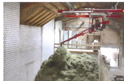
Baufehler bei Belüftungsanlagen verursachen hohe Stromkosten.
