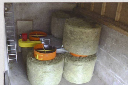
Mobile Kleinanlagen können eine Alternative zur Vergrößerung der Belüftungsanlage sein.
