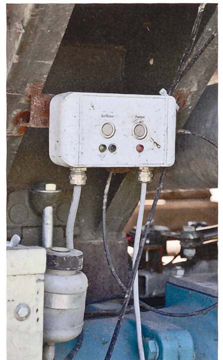
Empfangsstation auf dem Anhänger mit Pumpe. Hier kann bei Bedarf auch manuell bedient werden.
