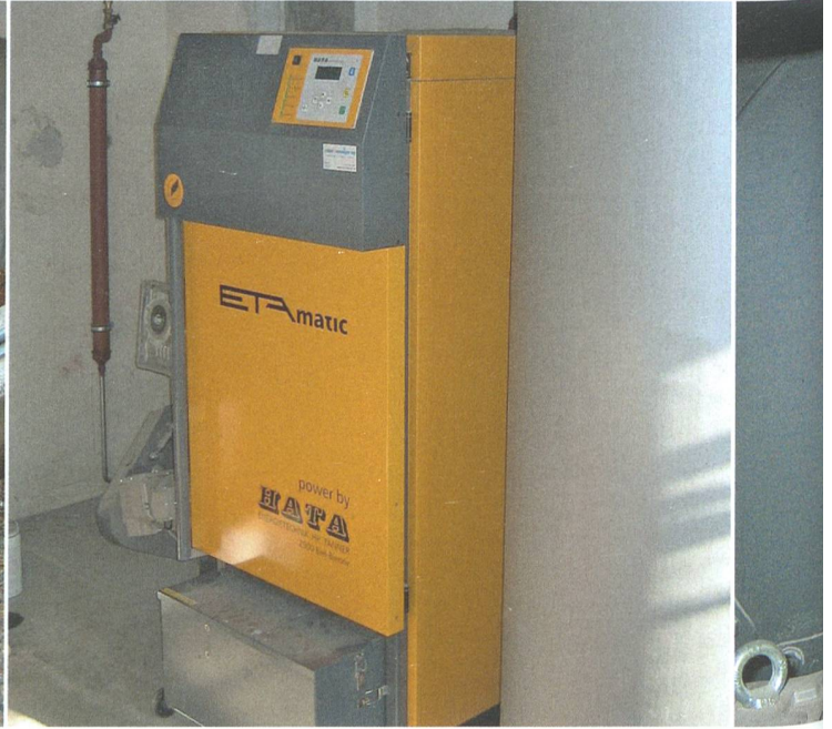
Schnitzelkessel in einer landwirtschaftlichen Liegenschaft, der auch einen Nahwärmeverbund der nahe gelegenen Einfamilienhäuser versorgt.
