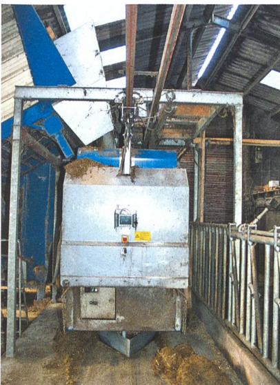
Abb. 6: Der RobotFeeder (Pellon) holt die Futterkomponenten bei den Futterbehältern ab und mischt sie bereits während der Beschickung mittels eines Mischkettensystems und einer horizontalen Schnecke. Über die zentrale Schnecke und ein Förderband erfolgt dann der Futterauswurf zur rechten oder linken Seite des Roboters.
