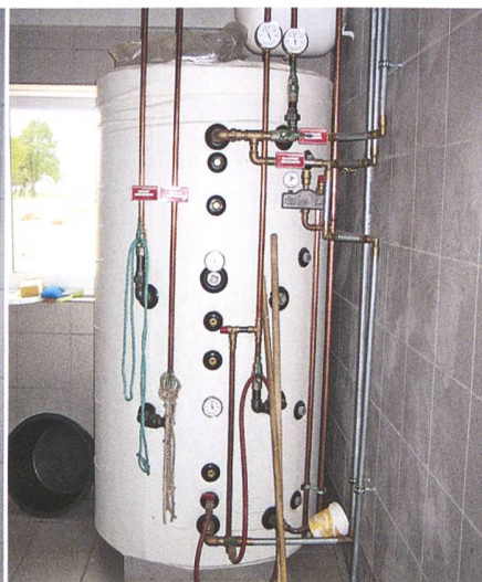
Zentraler Warmwasserspeicher einer Wärmerückgewinnungsanlage bei der Milchkühlung. Der Mehrverbrauch an Strom gegenüber der Milchkühlung ohne Wärmerückgewinnung ist sehr gering.
