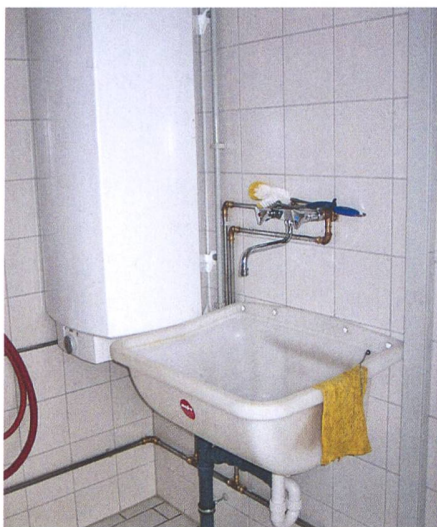
Wasch- und Warmwasserstation für einen Kälberstall mit eigenem Boiler (kein Wärmeverlust durch lange Leitungen). Der Waschröge hat eine ideale Form und der Wasserbedarf ist dementsprechend gering.
