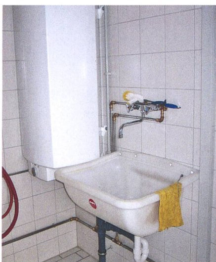
Wasch- und Warmwasserstation für einen Kälberstall mit eigenem Boiler (kein Wärmeverlust durch lange Leitungen). Der Waschtrog hat eine ideale Form und der Wasserbedarf ist dementsprechend gering.
