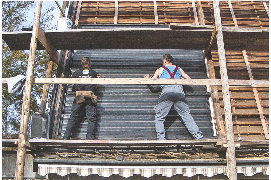
Montage von Sonnenkollektoren an einem Steildach. Anschliessend muss noch die Abdeckung angebracht werden. Eigenleistungen in Zusammenarbeit mit dem Installationsunternehmen sind hier durchaus möglich.
