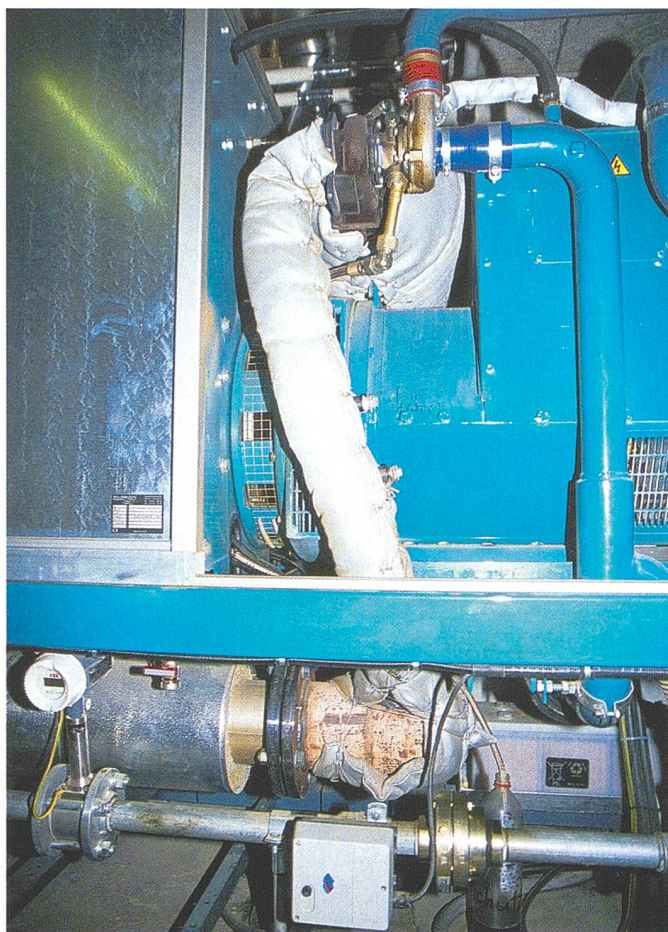
Details im Blockheizkraftwerk: Vordergrund oben Abgasturbolader mit Leitung zur Ladeluftkühlung. Hintergrund Russpartikelfilter. Unten Messsonde für die Bestimmung der Gaszufuhr und -qualität sowie Regulierung der Zufuhr. Links unter dem Zündstrahlmotor zum ersten Mal weltweit installiert: Katalysatorkolonnen, entwickelt bei Hug Engineering, Rätterschen ZH. (Bild: Ueli Zweifel)
