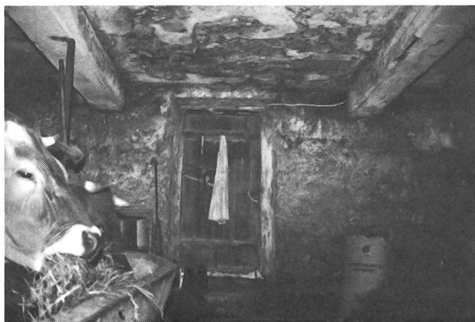
Isolier- und Lüftungsmängel: Schäden an einer Massivdecke nach 30 Jahren.
