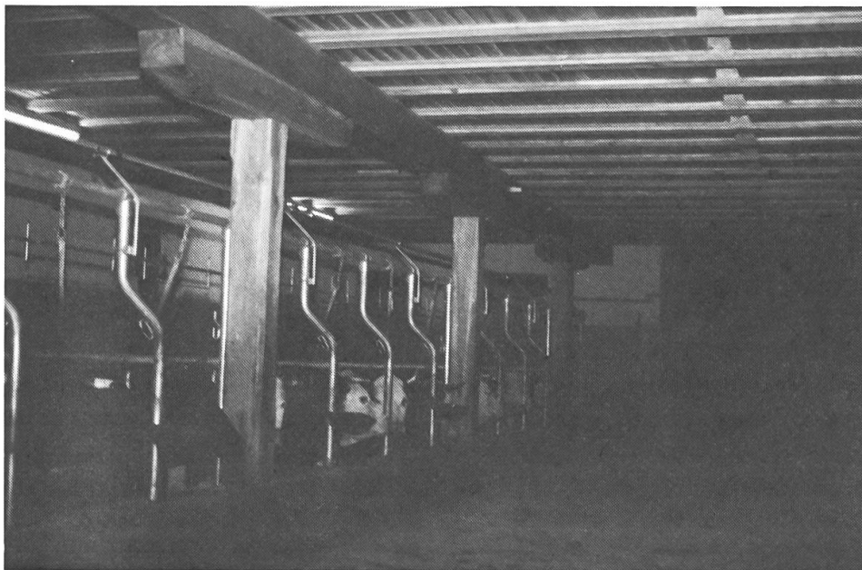
Durch Hinterlüftung der Decke ist auch bei bestehenden Stallbauten eine wirkungsvolle Sanierung möglich.
