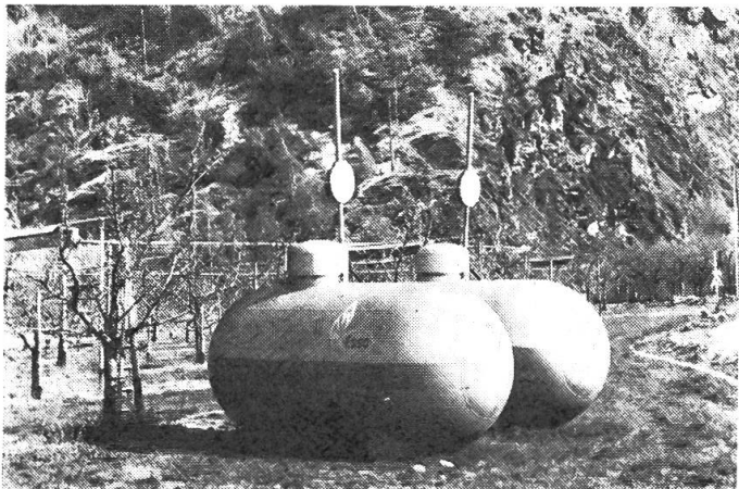
Abb. 6: Lagertanks für Flüssiggas.
