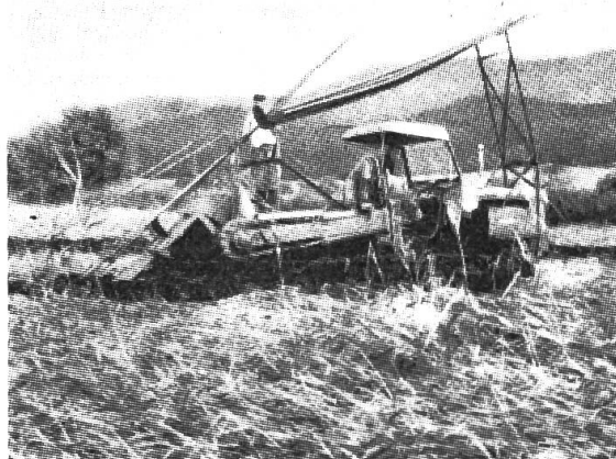
Die gleiche Maschine beim Ausheben der Erde und gleichzeitigen Verlegen von Tonrohren.
