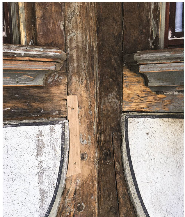
Musterstelle der durchgeführten Massnahmen. Schadhafte Holzpartien mit Echtholz-Vierungen ersetzt, rissiger und schuppiger Farbanstrich durch Schleifen entfernt, grobe Risse mit Ölkitt geschlossen. Foto: Denkmalpflege Stadt St. Gallen.
