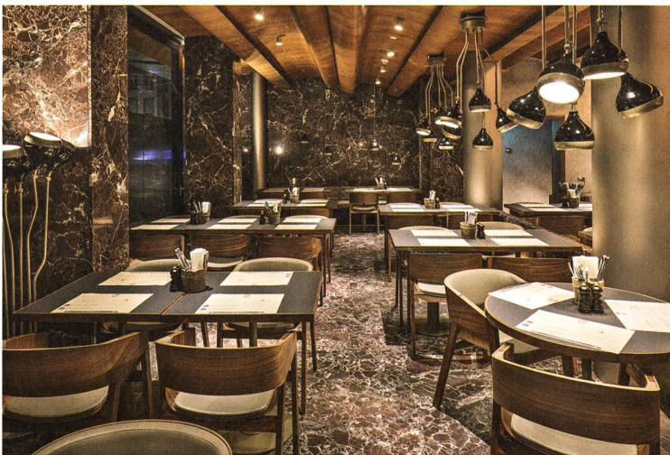
Die Wand im Hintergrund hätte zwecks Erdbebenertüchtigung verstärkt werden sollen, was die Entfernung der Marmorverkleidung bedingt hätte. Stattdessen konnte die notwendige statische Ertüchtigung mittels einer zusätzlichen Stütze (links hinten) erreicht werden. Das neue Mobiliar und die Leuchten lehnen sich an die ursprünglich von Architekt Heinrich Graf entworfenen Stücke an. Foto: Patrick Armbruster.
