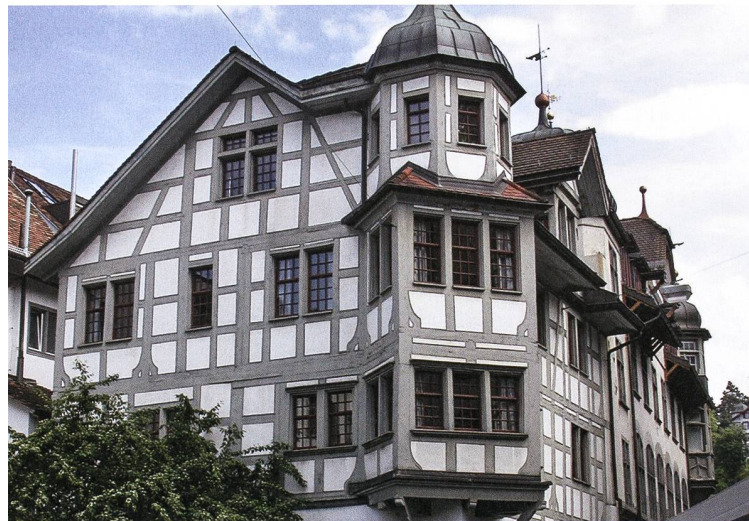
Aufnahme vor der Renovation 2019. Obwohl die letzte Fassadenrenovation fast 40 Jahre zurückliegt, sind das Riegelwerk und die verputzten Füllungen in einem guten Zustand erhalten, so dass sich die Unterhaltsarbeiten auf die wenigen Schadstellen im Riegelwerk und Verputz sowie einen neuen Farbauftrag auf dem Holz- und Mauerwerk beschränken konnte. Foto: Denkmalpflege Stadt St. Gallen.
