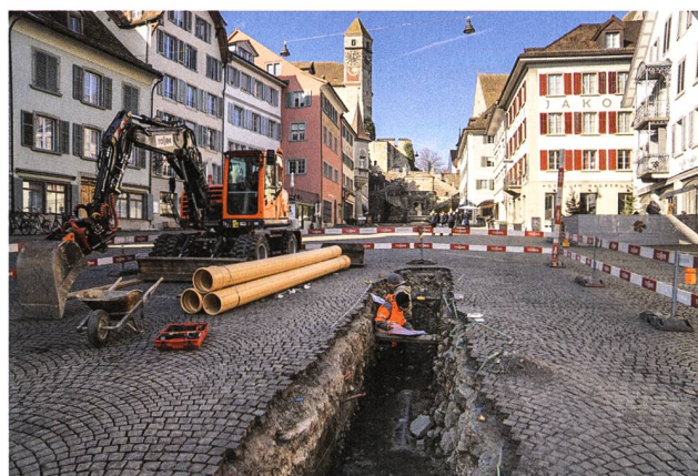
Rapperswil-Jona, Rapperswil, Hauptplatz. Nadja Oertle und Marco-Joshua Fahrni dokumentieren Grabenprofile. Aufnahme KASG.
