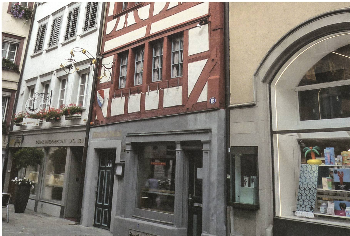
Riegelfassade des Bäumli wie sie bei der Renovation 1976 wieder hervorgeholt und restauriert wurde. Zu erkennen ist die leichte Ausbuchtung über dem Reihenfenster im 1. Obergeschoss, welche wohl massgeblich für den nun behobenen Bau-schaden verantwortlich war.
