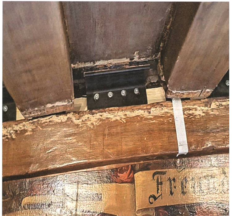
Die neuen, an den Sturzbalken verschraubten Winkelleisen dienen als eigentliche Auflager für die Dielen und indirekt auch für die Bälkchen, da diese mit den Dielen vernietet sind.
