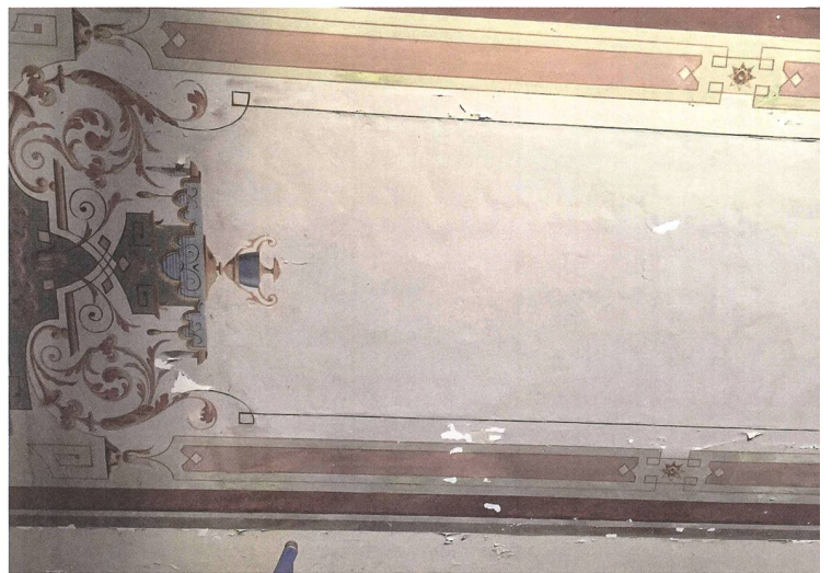
Schadensbild vor der Restaurierung. Insbesondere an den Rändern der Malereien waren die Schäden gross, aber auch an den figürlichen Partien fanden sich Beschädigungen.
