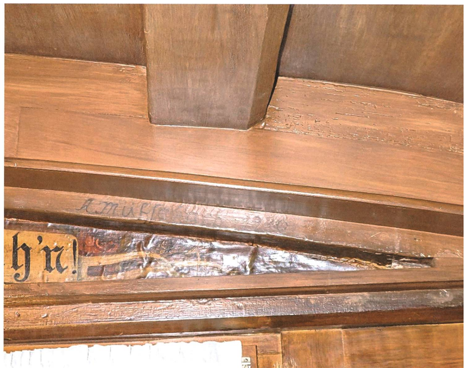
Ansicht nach Abschluss der Arbeiten. Zu erkennen sind die Aufdopplung zum Schutz der Balkenköpfe und die ergänzte Fassung der Maserierung.
