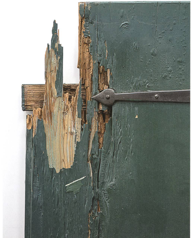
Bauteilschutz durch Farbanstrich. Eine der Hauptaufgaben eines Farbanstrichs ist der Schutz des darunterliegenden Untergrundes vor Zerstörung. Bei einer unsachgemässen Kombination von Untergrund und Anstrichmittel kann letztlich ein Anstrich den Untergrund gefährden oder gar zerstören. Beispiel eines Fensterladens: Aufgrund einer falschen Grundierung verfaulte das Holz unter dem weitgehend intakten Anstrich.
