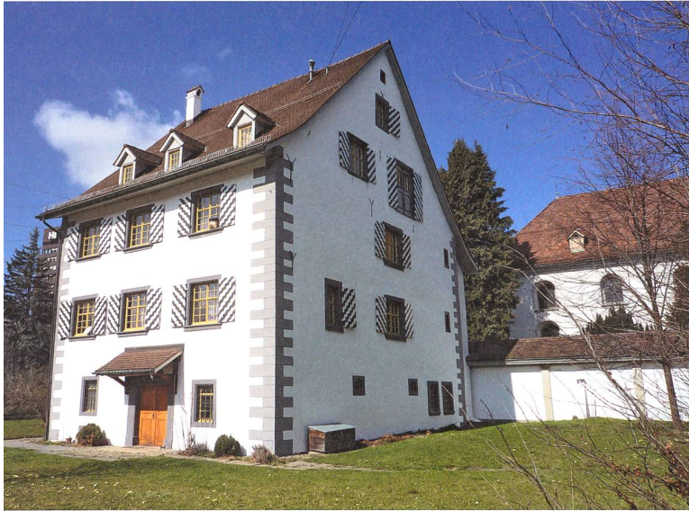
Bild oben: Zustand vor der Renovation (2016) mit ausgebleichten und verschmutzten Fassaden und roten Fenstern.
