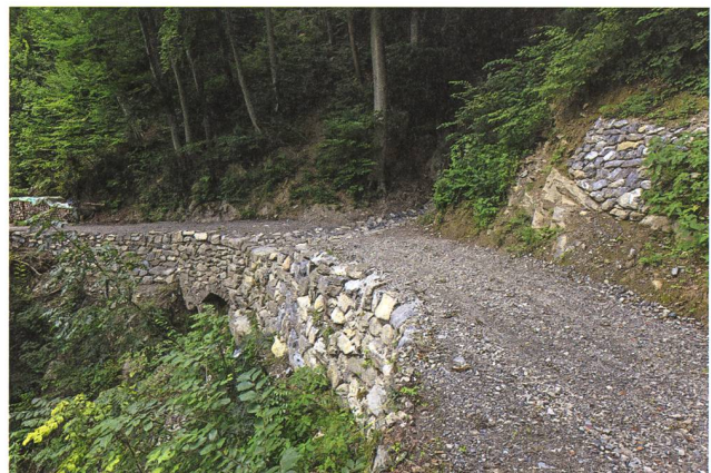
Sargans, Alte Schollbergstrasse. Blick auf die sanierte Atschabachfurt gegen Westen. Aufnahme: C. Doswald/KASG.
