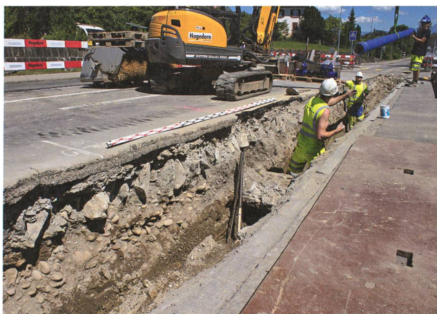
Rapperswil-Jona, Kempraten, Zürcherstrasse. Baubegleitung während des Neubaus der Wasserversorgung. Im Profil Reste der Strassenpflasterung des 18. Jahrhunderts. Aufnahme: KASG.
