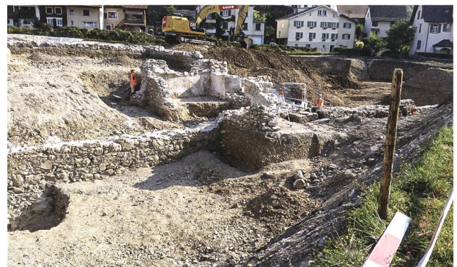
Weesen, Staad. Blick auf die Kontermauer und die Reste des Staadhauses. Foto KASG.
