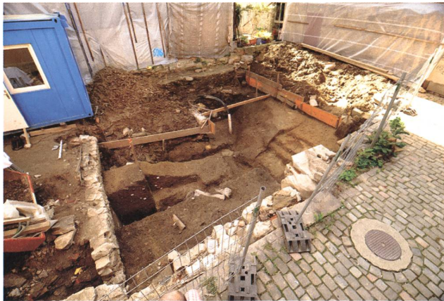
St. Gallen, Schwertgasse 15. Blick auf den ehemaligen Hinterhofbereich und den teilweise ausgenommenen Graben. Foto KASG.
